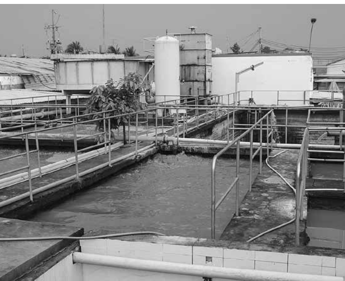
▲ Hệ thống XLNT của Nhà máy đông lạnh 07 với công suất xử lý 1.200 m 3 /ngày, đêm
